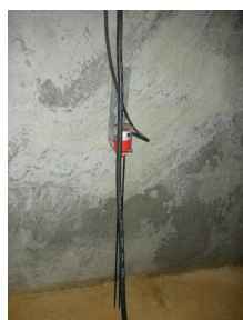
Alarm for vand på gulv i kælder
