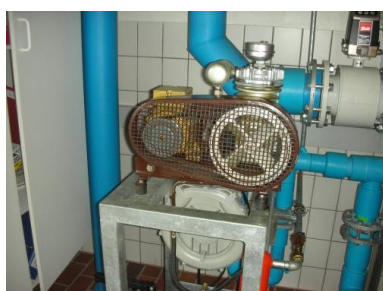
Kompressor råvand Skyllerpumpe og kapselblæser
