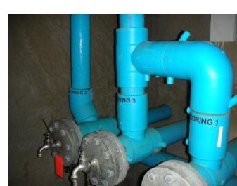
Indgang råvand - 3 adskilte rør
